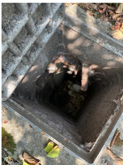
污水井无水位
